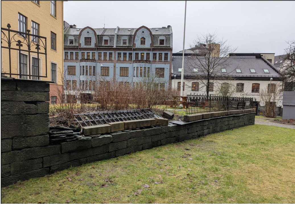
Figur 43: Mur og jernstakitt mellom gravfelt B og Katedralskolen. Gjerdet er festet i granittblokker plassert på skiferheller over murene. Gjerdet er delvis veltet (Foto: Byantikvaren, 2025).
