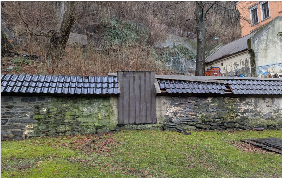
Figur 38: Tidligere portåpning, som er stengt igjen av et plankegjerde i den gamle steinmuren mot øst (Foto: Byantikvaren, 2025).
